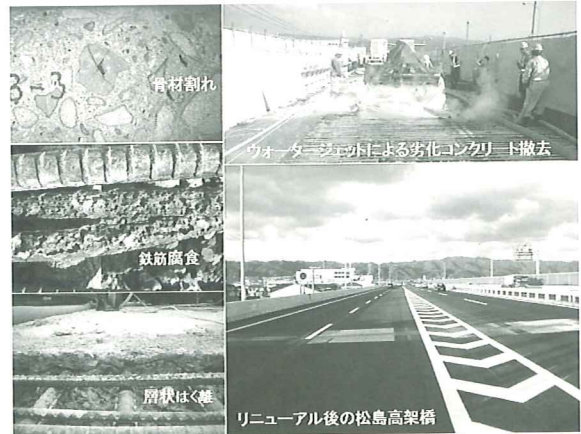
■松島高架橋の劣化損傷状況と劣化部コンクリートの撤去、リニューアルの完了
